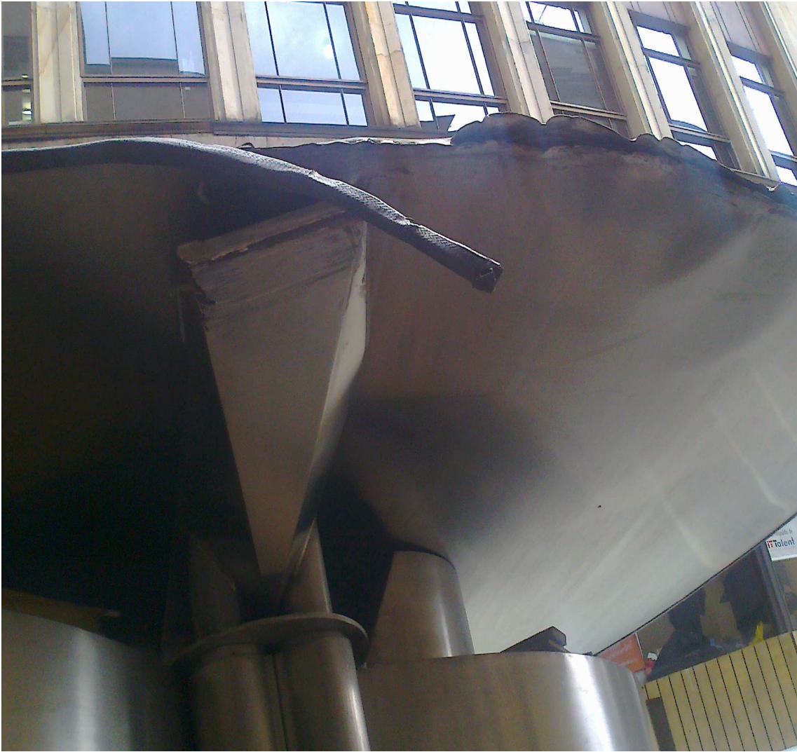
Quiosco ubicado en la calle 14, entre carrera Séptima y octava, deteriorado, por efecto de accidente de tránsito ocurrido en agosto de 2011.
