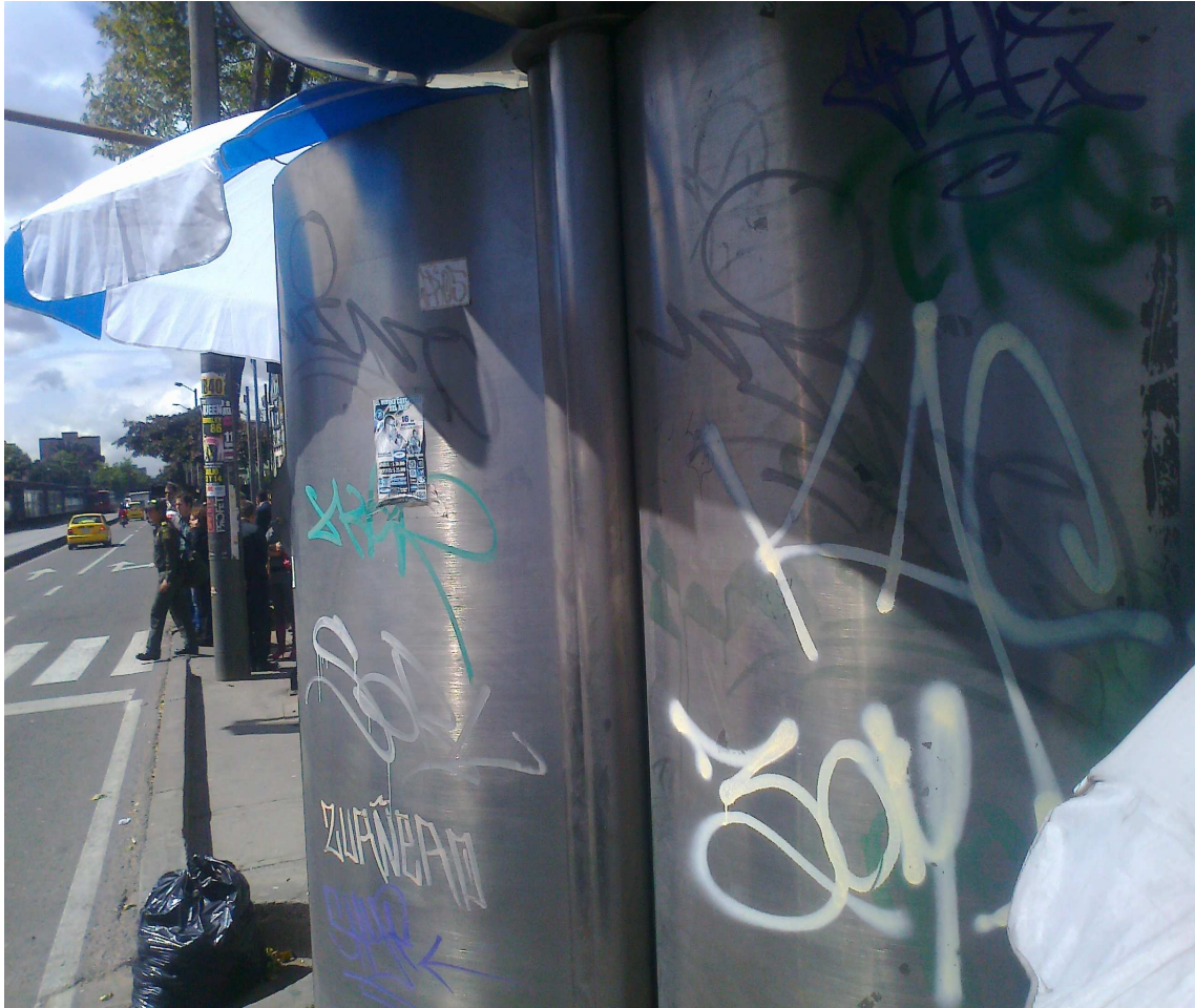
Quiosco 109A y B, localizados en la Avenida Caracas con calle 37, donde se evidencia las afectaciones, por efecto del vandalismo y falta de mantenimiento.
